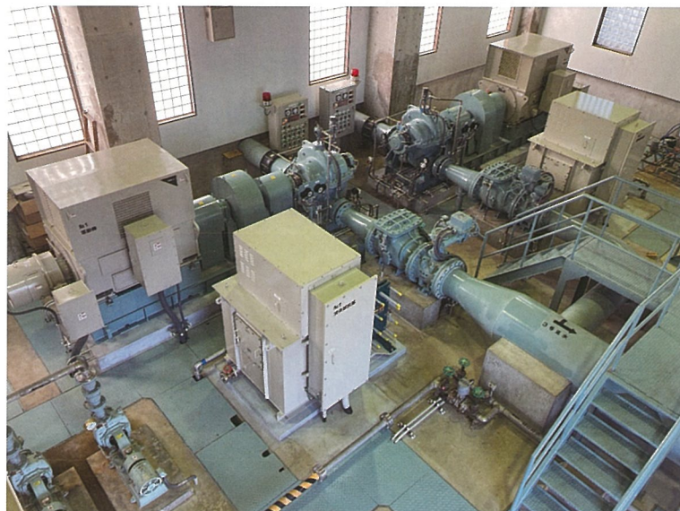
【第3段揚水機場】
