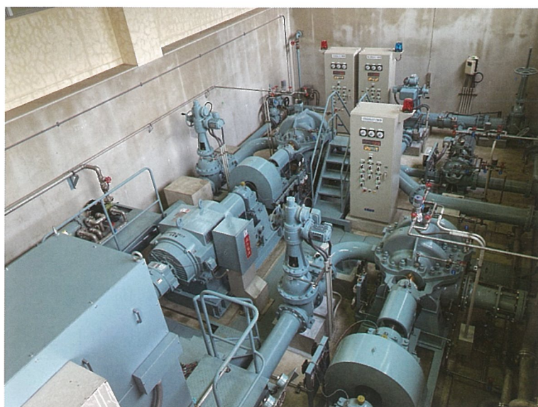
【第4段揚水機場】
