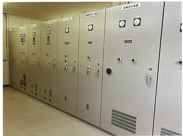
第4段揚水機場電気設備
