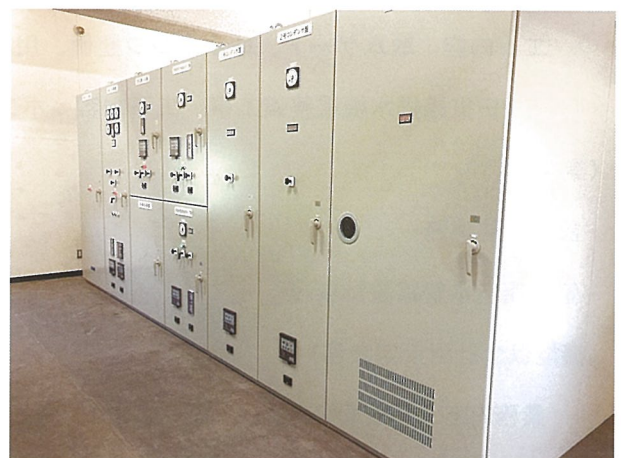
第3段揚水機場 電気設備
