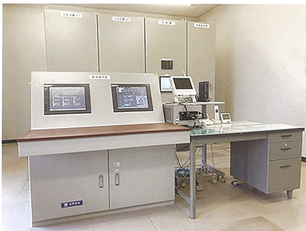
第3段揚水機場 操作卓
