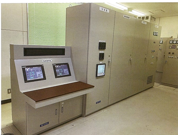
第4段揚水機場操作卓
