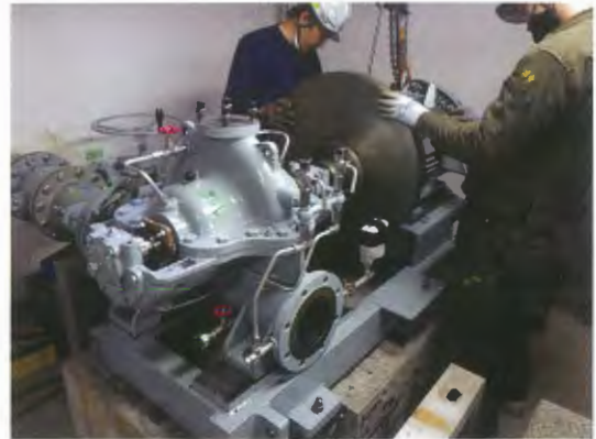
山本新田支線揚水機場（ポンプ設備整備中）
