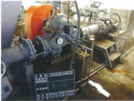
山本新田支線揚水機場（ポンプ設備整備前）
