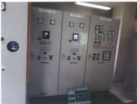
山本新田支線揚水機場（電気設備整備前）
