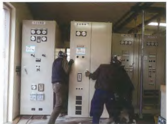
山本新田支線揚水機場（電気設備整備中）
