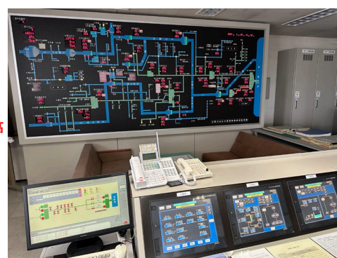
水管理施設 (中央管理所)
