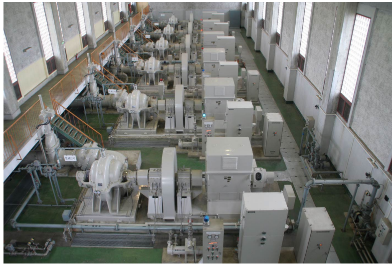
( 第1段場水機場 )
