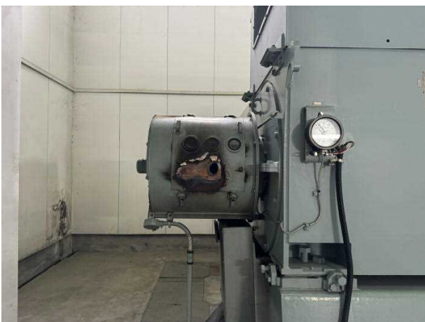
電動機集電部
