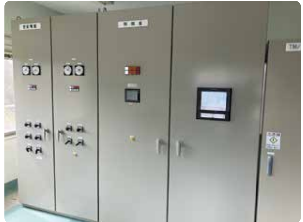
受配電盤、制御盤
