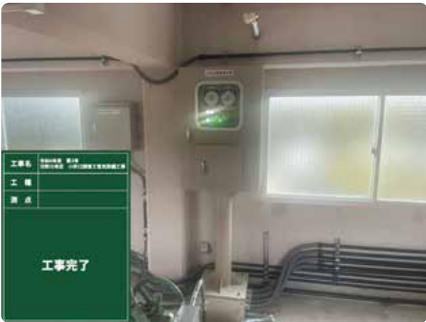
土砂吐ゲート機側操作盤
