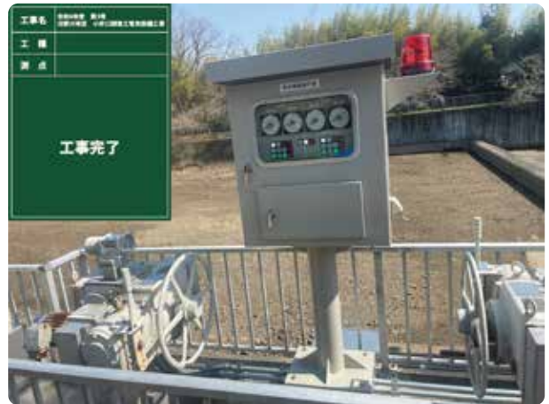
取水ゲート機側操作盤
