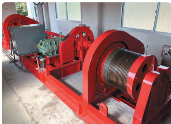
土砂吐ゲート巻上機 整備後
