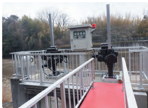
取水ゲート開閉器 整備後
