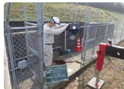
電動開閉器（12号）
