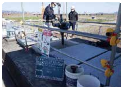
電動開閉器（10号）
